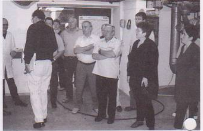
Stadträte und Kandidaten der CSU besichtigen das Untergeschoss des Hallenbades. Die erheblichen Schädigungen werden von außen gar nicht so sichtbar, wie man sie erkennen kann, wenn man "vor Ort" ist.
