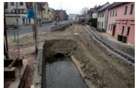
Das verrohrte und zugeschüttete Flussbett.
